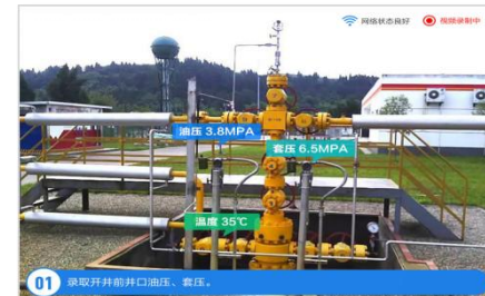
西南首个-中石油西南油气田5G智慧油气田项目
